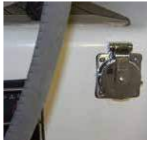
Kuva 3.4. Tyypillinen veneeseen asennettu liityntärasia maasähkön kytkentään.
