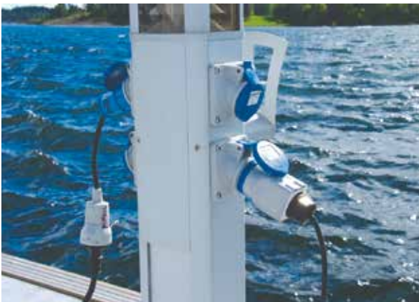
Kuva 3.2. On sallittua tehdä siirtymäjohto tai adapteri pyöreän pistotulpan ja sukon välille. Kuvassa mahdollisia ratkaisuja. Johdon pitää olla niin lyhyt, ettei johdon päässä oleva pistotulppa ylety veteen tai maahan. Adapterien käyttöä tulisi kuitenkin välttää, koska vaihe- ja nollajohtimet saattavat mennä ristiin.
